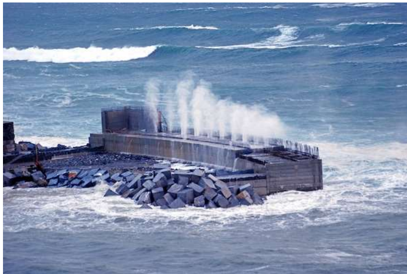
Figura 4.9: Central de olas de columna de agua oscilante (OWC) en Mutriku, España.
