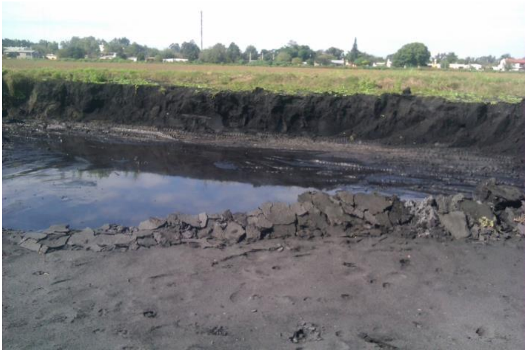
Piletones de sedimentación de ceniza
