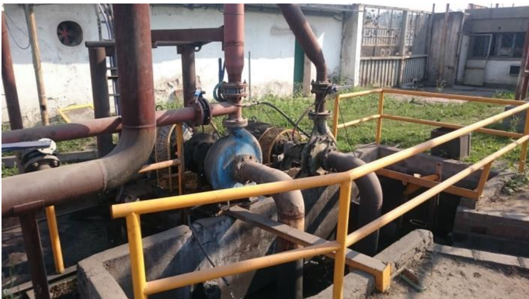
Bomba de retorno de piletones
