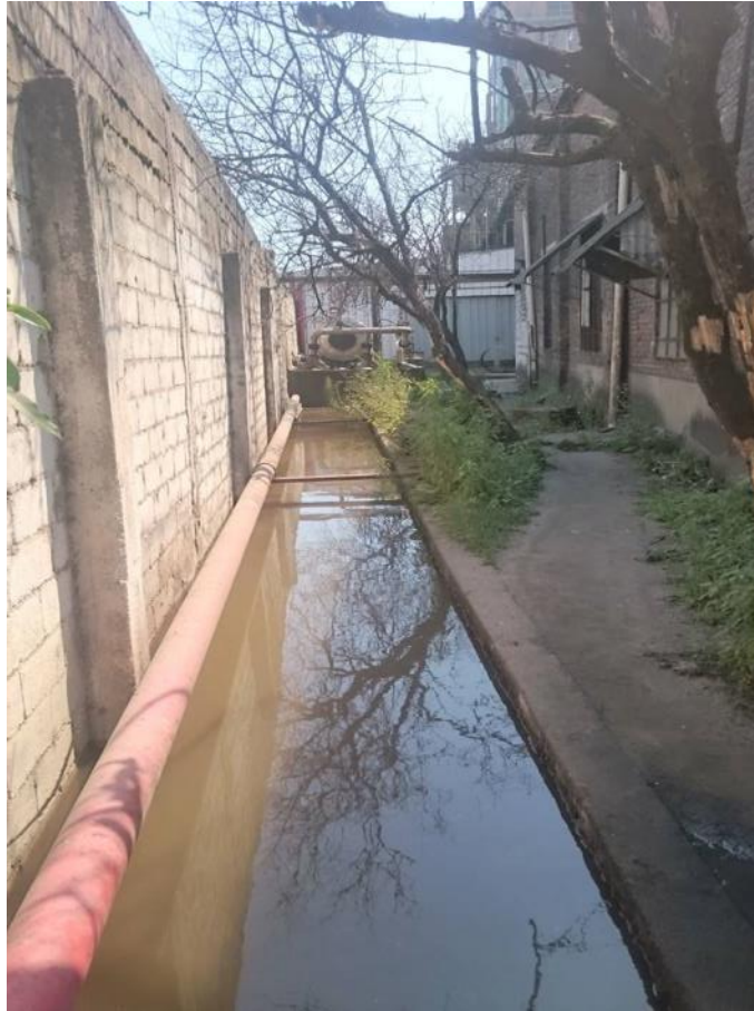
Canal interno de fábrica
