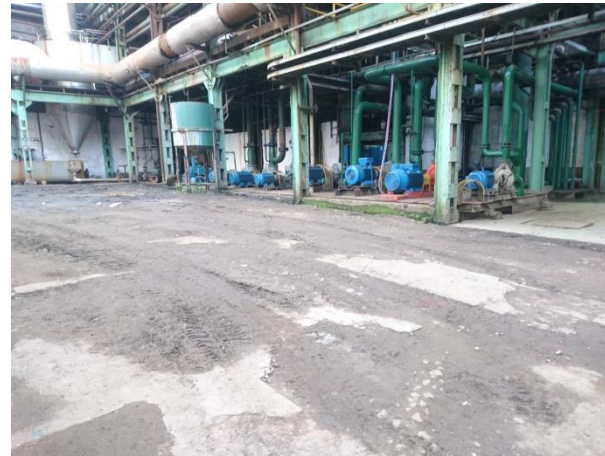
Bombas de Agua
