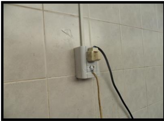
Fig 18: Condición insegura en instalación eléctrica.
