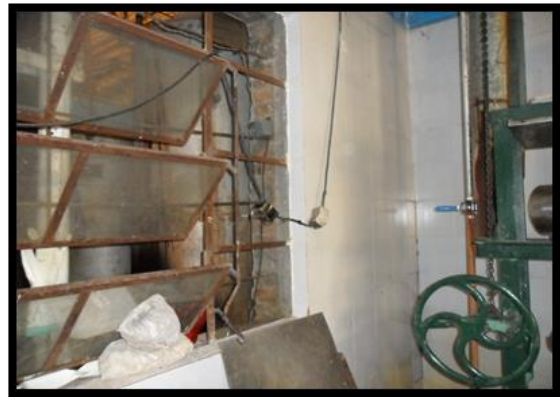
Fig 19: Condición insegura en instalación eléctrica.
