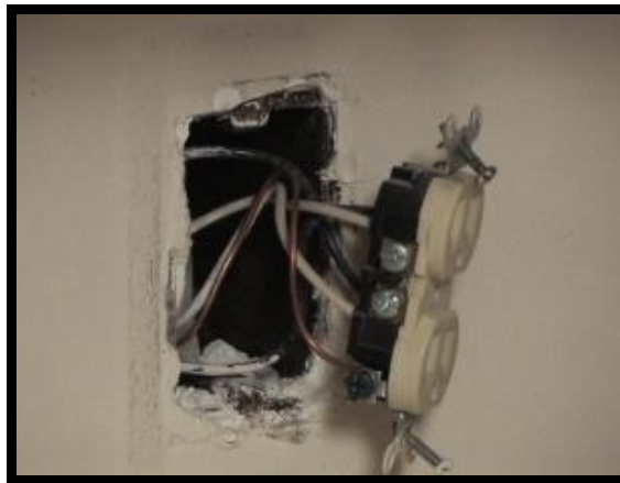
Fig 20: Condición insegura en instalación eléctrica.
