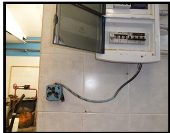
Fig 17: Condición insegura en instalación eléctrica.
