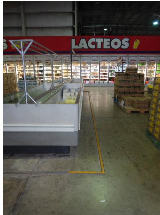
vista de heladeras y walk in cooler al fondo
