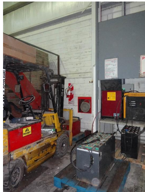
Sector de recarga de baterías
