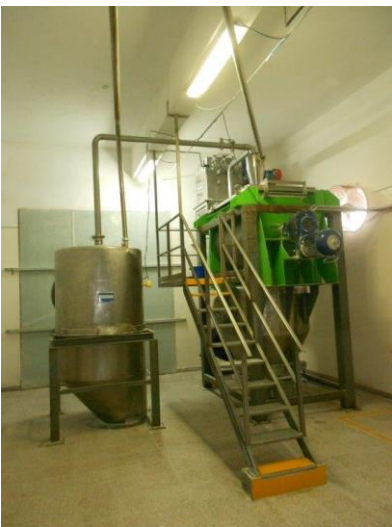
Sala de Mezcla y Silo de Puré
