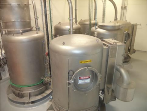
Silos de almacenaje
