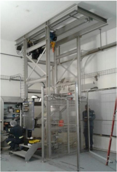
Estación de descarga (vuelco) de materia prima
