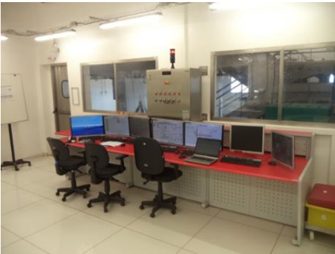
Sala de control del proceso de fabricación de polvos
