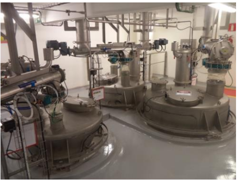
Sala de mezcla
