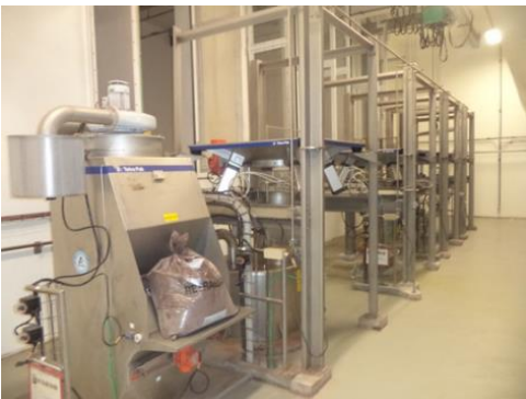
Sala de abastecimiento y dosificación.
