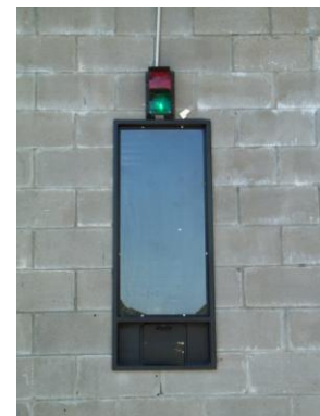
Semáforo Verde "Mover Camión término la operación"
