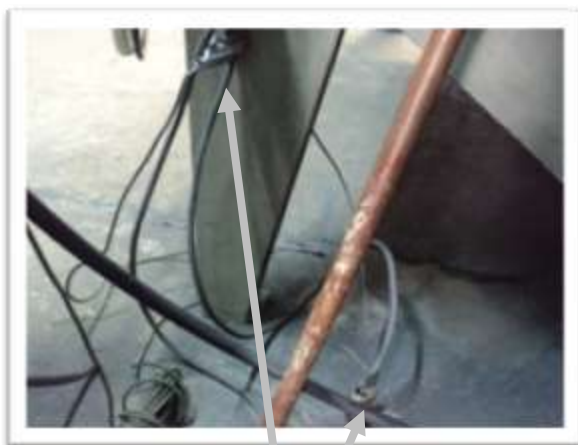
CONEXIÓN A TIERRA DE LA CABINA A LA MISMA JABALINA DEL EQUIPO
