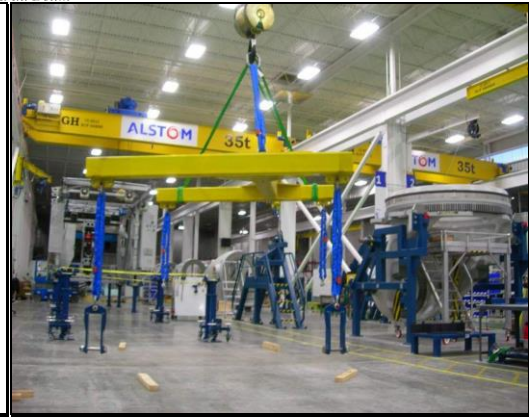
Puente de grúa
