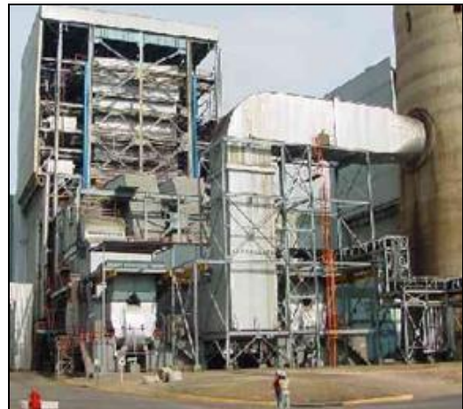
Fig. 2 Caldera de vapor
