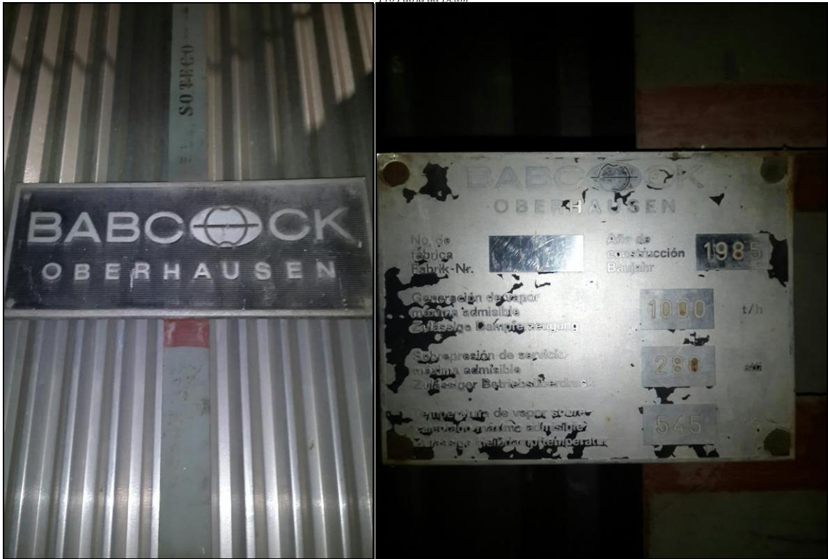
Marca de la caldera y datos
