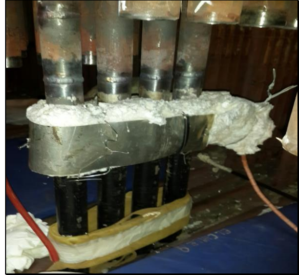
Serpentinas soldadas en tratamiento térmico
