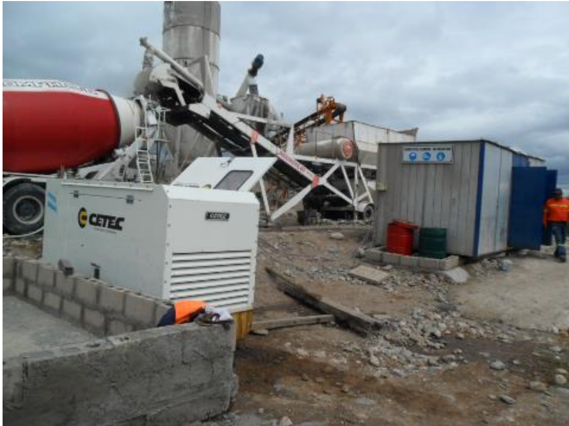
Imagen 28 - Planta de hormigón en operación
