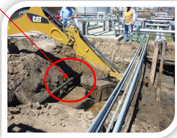
Figura 7. Interferencia en excavación mecánica.
