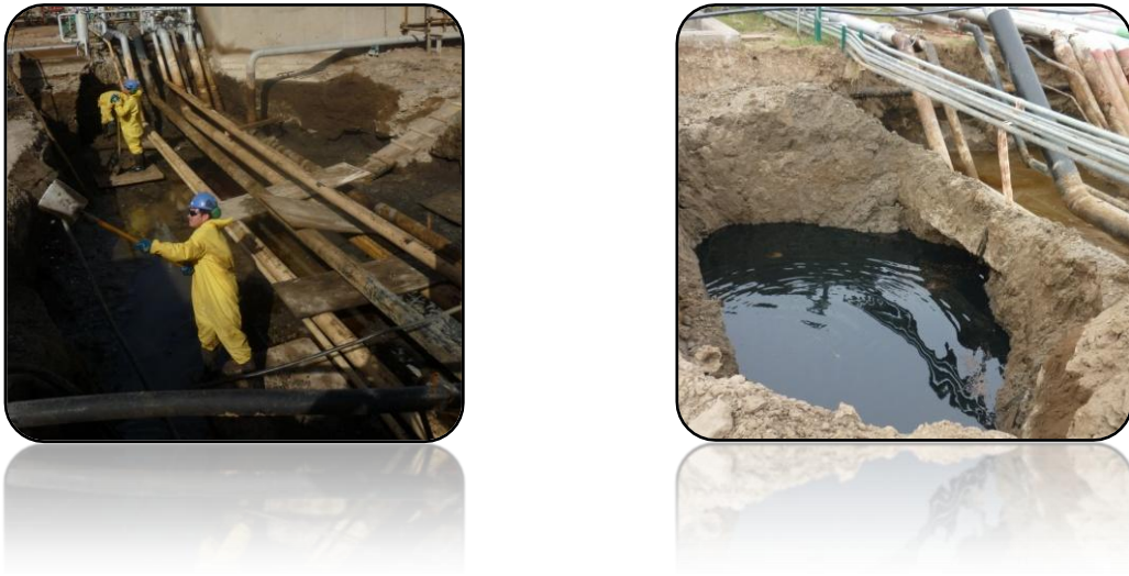
Figura 2. Suelo y agua contaminados por combustible.
