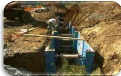
5.6.4.- Caída de personas, materiales y vehículos al interior.
