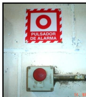
Pulsador de Alarma
