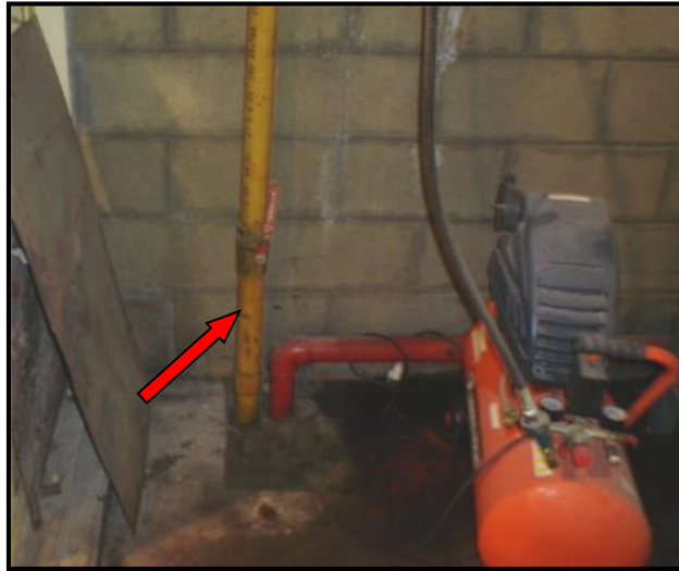
Cañería de Gas Planta
