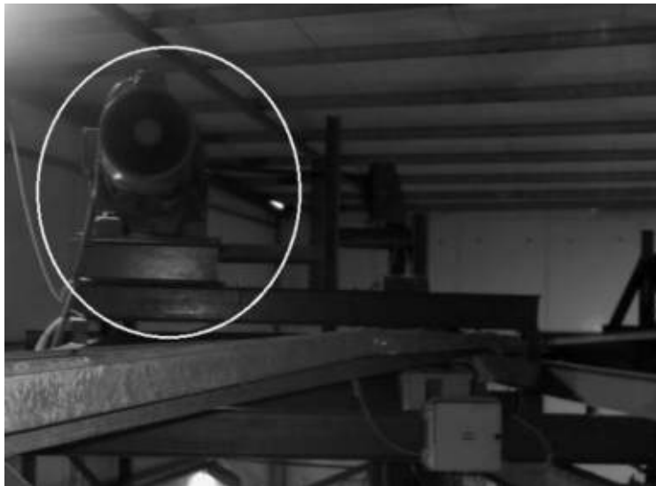
Aparejo o malacate eléctrico con resguardo fijo de seguridad de sus partes móviles, ubicado por encima de los rieles del techo del sector faena, son utilizados para izar el animal insensibilizado.
