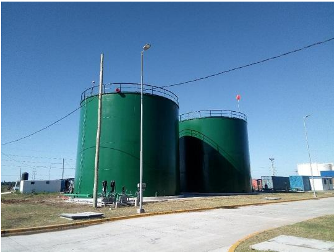
TANQUE TK-102 AGUA BLANDA (IZQUIERDA)- TANQUE TK-102 AGUA DURA (DERECHA)
