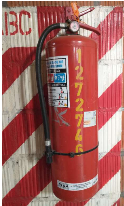
Foto 2.2 - Extintor PQS de 5 Kg
