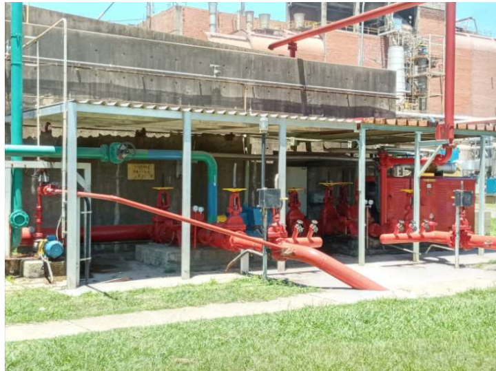
Foto 2.5 – Bombas de red de incendio
