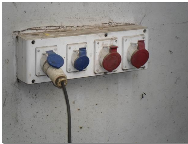
Figura 18 – Módulos de toma eléctrica estandarizados.
