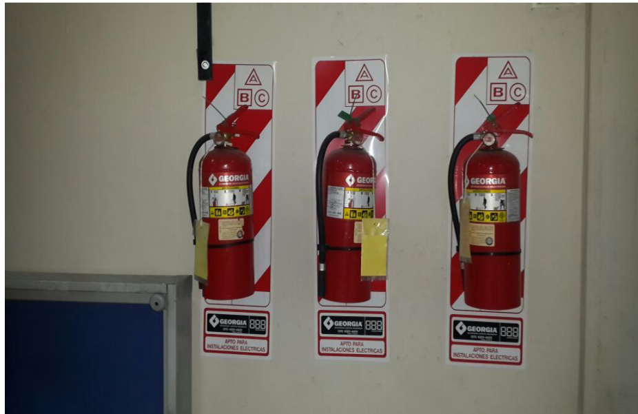
Foto 1, matafuego Deposito y salón comercial
