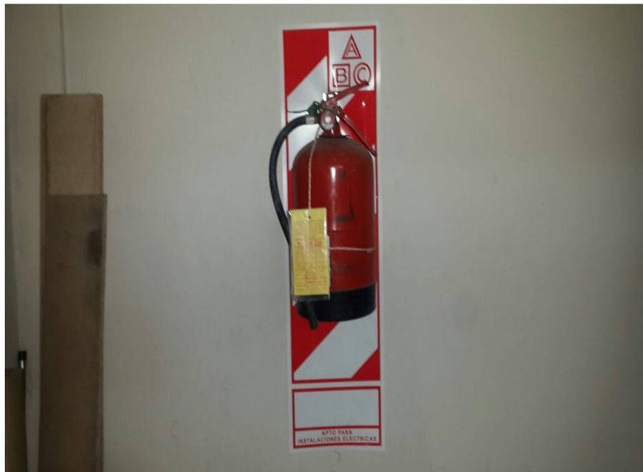
Foto 2, matafuego Deposito y salón comercial
