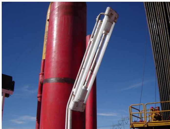
Foto 29 – Luminaria a prueba de explosión (APE) en piqueta
