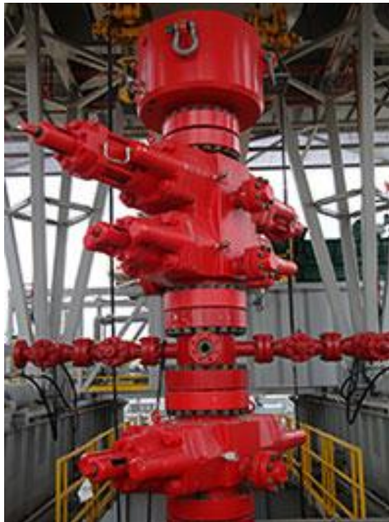
Foto 7- Conjunto de válvulas BOP (Blow Out Preventor)
