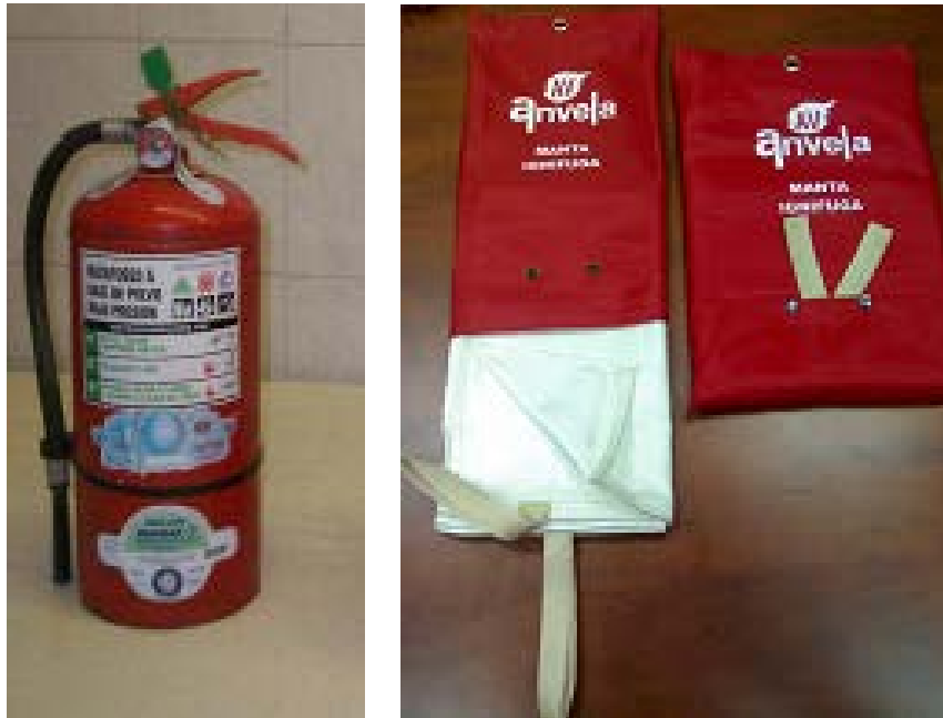
Figura 5.5.4. d) Extintor triclase y manta ignífuga
