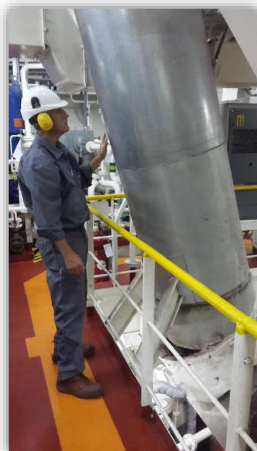
Foto 23: aislamiento acústico y térmico a la salida del escape del motor principal, se destaca su importante grado de aislación. Fuente: elaboración propia
