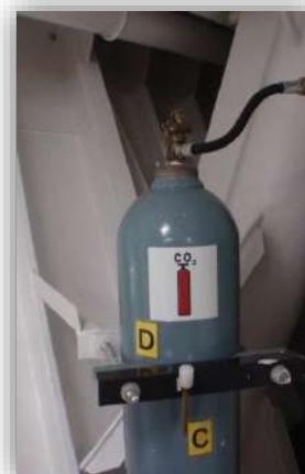
Foto 52: Botellón de CO 2 de 45Kg, ubicado en el pañol de pintura en el castillo de proa. Fuente, elaboración propia.
