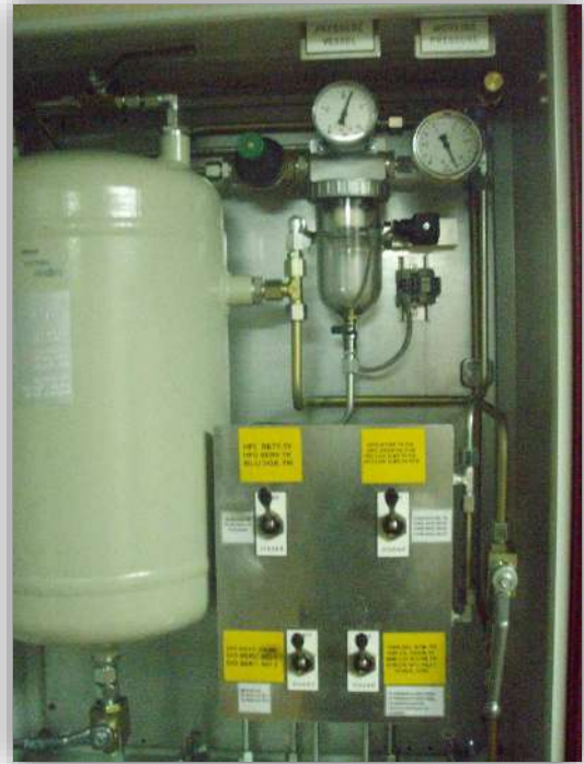
Foto12: sistema neumático de corte de combustible de motor principal en caso de incendio. Fuente, elaboración propia.
