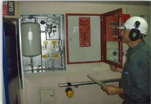
Foto 36: Durante las pruebas pudo comprobarse la efectividad del sistema neumático de corte de combustible, activado en caso de incendio, el dispositivo corta el paso de combustible al motor principal. Fuente, elaboración propia.
