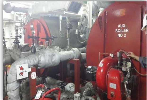
Foto22: El cuarto de calderas de vapor, se encuentra separado de la sala de máquinas por un mamparo metálico con una puerta de acceso acústicamente tratada. Fuente: elaboración propia
