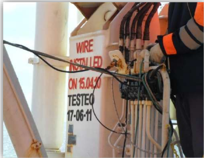
Foto 78: Las inspecciones de seguridad permiten detectar en forma temprana el mal funcionamiento de un sistema hidráulico de asistencia a Botes Salvavidas “Pampa Sur B”. Fuente, elaboración propia.
