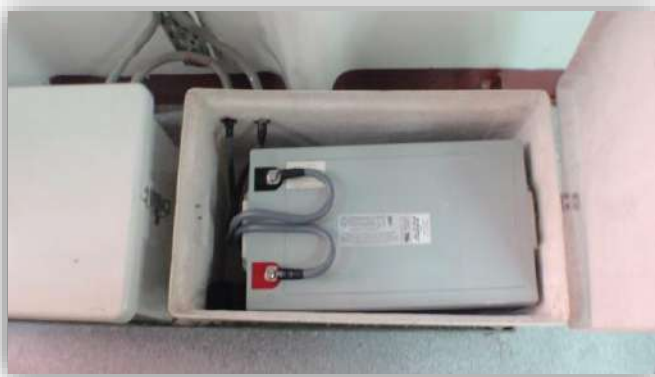
Foto 56: Baterías para el arranque de emergencia.: Fuente, elaboración propia.
