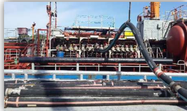
Foto 4: Manifold de conexiones de manguerotes de carga/ descarga. Fuente, elaboración propia.
