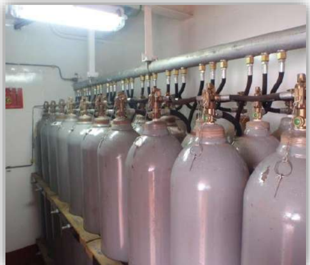
Foto 50: 32 botellones de CO 2 alimentan el sistema de protección de incendio de la sala de máquinas. Fuente, elaboración propia.
