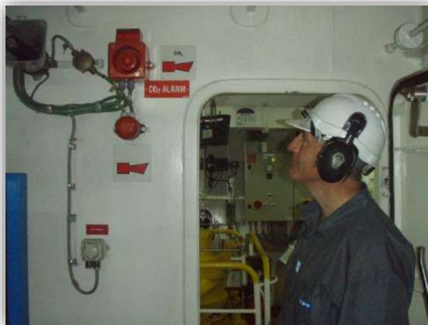
Foto 16: alarma sonora de 95db para alertar el desalojo de la sala de máquinas para ser inundada con CO2. Fuente, elaboración propia.
