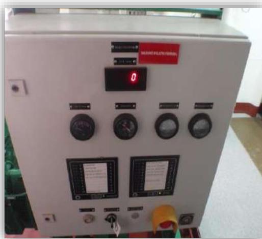
Foto 56: Tablero de control eléctrico del generador de emergencia. Fuente: elaboración propia
