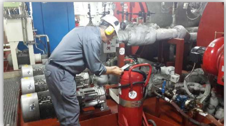
Foto 67: Extintor móvil en sala de Calderas de la sala de máquinas. Fuente elaboración propia.
