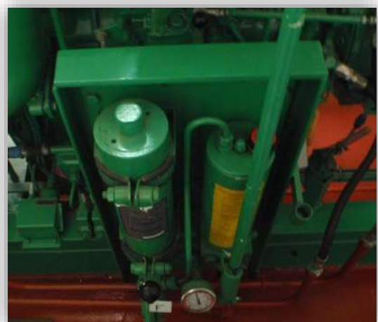
Foto 56: Sistema hidráulico de arranque de generadores de emergencia como alternativa al uso de baterías. Fuente, elaboración propia.
