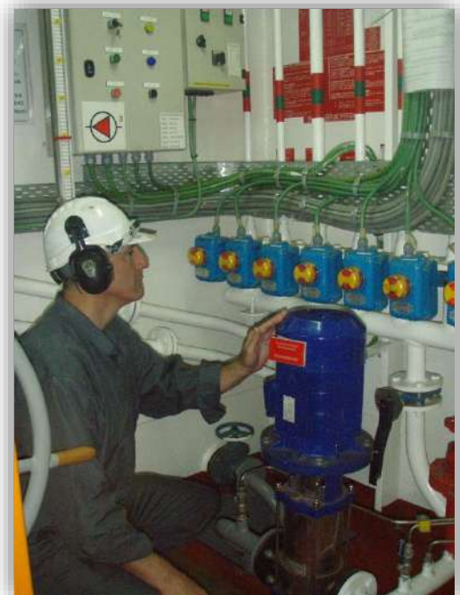
Foto 9: Control de sistema WaterMist anti Incendio en Sala de Máquinas. Fuente, elaboración propia.
