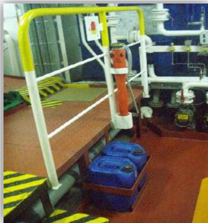
Foto 58: Extintores de espuma portátil máquinas. Fuente elaboración propia
