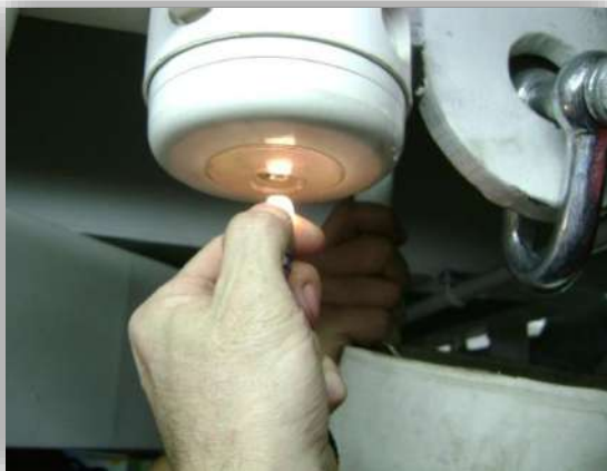
Foto 42: Detector de llama, simulador de alarma de luz infrarroja y UV para forzar activación y comprobar funcionamiento. Fuente elaboración propia.
