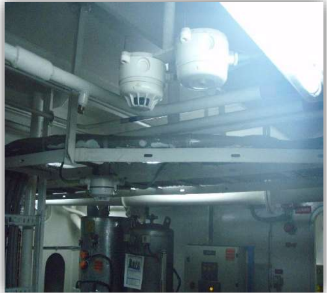
Foto 44: Detectores de Humo y Llama en sala de máquinas del "Pampa Sur B" los mismos activan el sistema automático de rociadores. Fuente, elaboración propia
