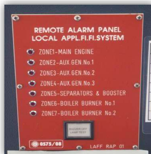
Foto 66: Remote Alarm Panel, indica a través de un LED destellante, la falla de uno de los detectores de incendio. Fuente, elaboración propia.
