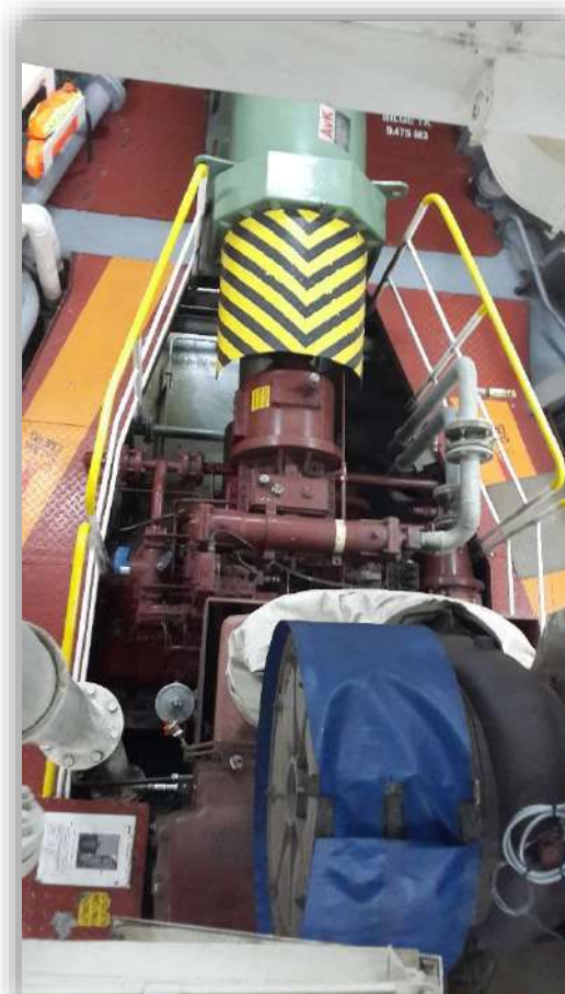
Foto 29: Puede apreciarse la uniformidad de la iluminación en zonas del eje del motor principal de la hélice. Fuente: elaboración propia
