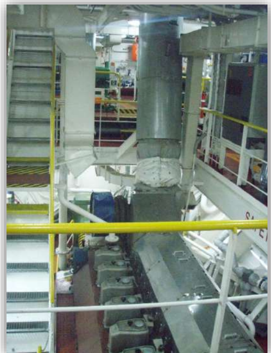
Foto 7; vista parcial Motor Principal Pampa Sur B con su protección de escape aislante de ruidos y temperatura. Fuente, elaboración propia.
