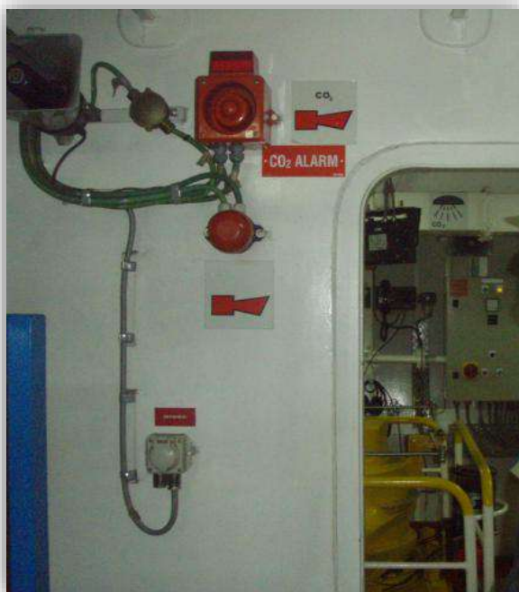
Foto 65: Señal audible y óptica en la sala de máquinas del "Pampa Sur B". Fuente, elab. Propia.
