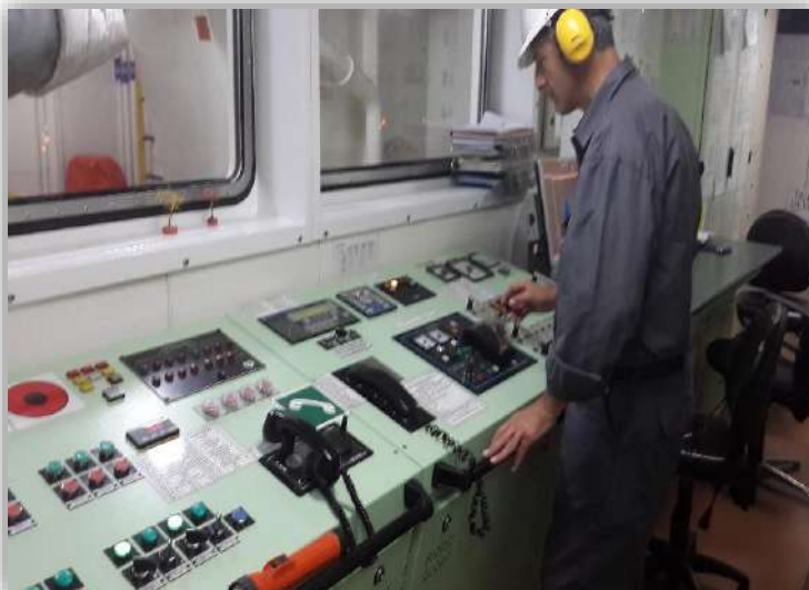
Foto 26: Cuarto de control Sala de Máquina, "Pampa Sur B" pueden observarse sobre la consola de control los equipos de comunicaciones. Fuente: Elaboración propia
