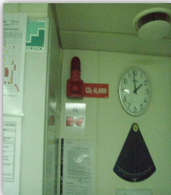
Foto 64: en el cuarto de carga, lejos de la sala de máquinas, se encuentra una de las sirenas de alarma de la activación de la batería de botellones de CO 2 . Perteneció a la familia de señales audibles y ópticas Fuente, elaboración propia.
