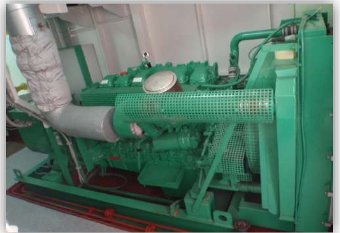
Foto 56: Generador de emergencia. Fuente: elaboración propia
