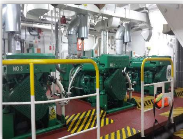
Foto 30: Intensa luz sin deslumbramientos sobre los tres generadores. Fuente, elaboración propia
