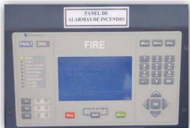
Foto 45: Panel de alarmas de Incendio. El mismo se encuentra en el puente de navegación y en él se centraliza información de estado de detectores de alarma o activación de alguno de ellos por incendio. Fuente, elaboración propia
