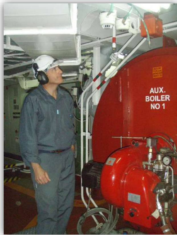
Ilustración 10: Vista de la Caldera N°1 así como de los sensores de humo y llama de la sala de máquinas. Fuente, elaboración propia.
