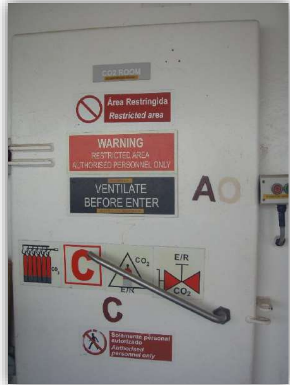
Foto 69: Clara señalización sobre las precauciones a tener en cuenta. En este caso cuarto de botellones de CO2. Fuente, elaboración propia
