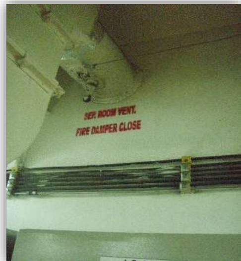
Foto 49: Damper para cierre de la ventilación de la sala de máquinas. Si bien el accionamiento no es automático el mismo se acciona desde la sala de control o desde el puente o desde el cuarto de carga. Fuente. Elaboración propia
