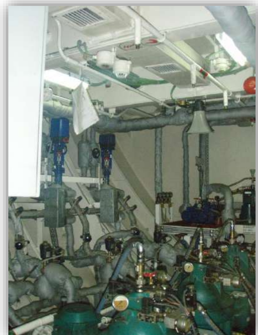
Foto 37: Detectores de Humo y llama en sala de bombas purificadoras, pueden apreciarse a la derecha de los mismos contra el techo la línea de alimentación de los rociadores, Fuente, elaboración propia.
