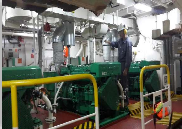
Foto 20: Generadores eléctricos "Pampa sur B", es elevada la presión acústica que los mismos emiten. Fuente: elaboración propia
