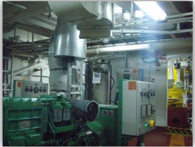
Foto 7: generadores B/T Pampa Sur B. Vista de la sala de Máquinas. Fuente, elaboración propia.
