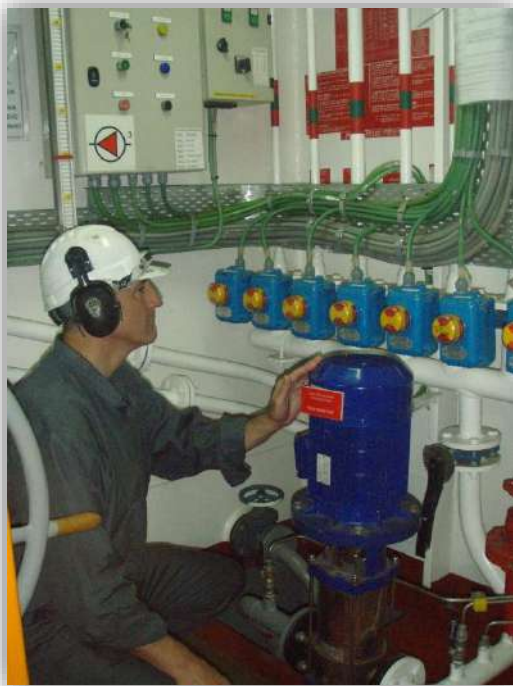
Foto 40: inspección del sistema de rociadores "Water Mist" ubicado en el Cuarto de Timón. Fuente, elaboración propia
