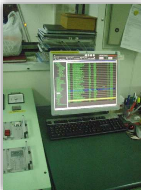
Foto 11: Computadora central de control de sala de máquinas, Fuente, elaboración propia
