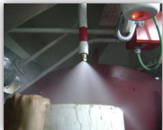
Foto 42: Sistema de rociadores "Water Mist" o niebla, obsérvese el detector de llama activado. Fuente, elaboración propia.
