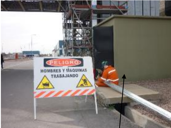
Foto 1. Cámara eléctrica de hormigón armado
