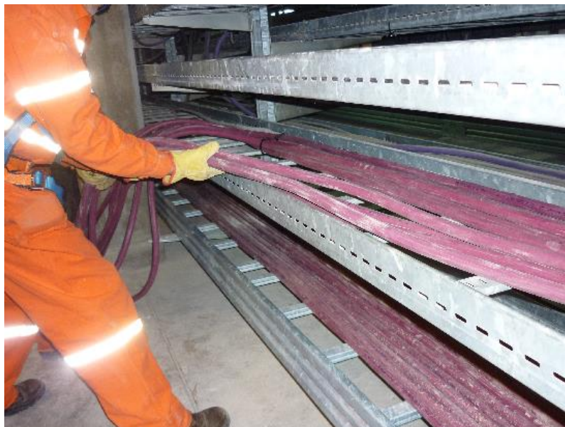
Foto 10. Acomodamiento de conductores eléctricos.
