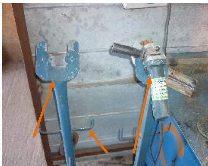
Foto 6. Pedestales de apoyo para amoladoras y discos de corte
