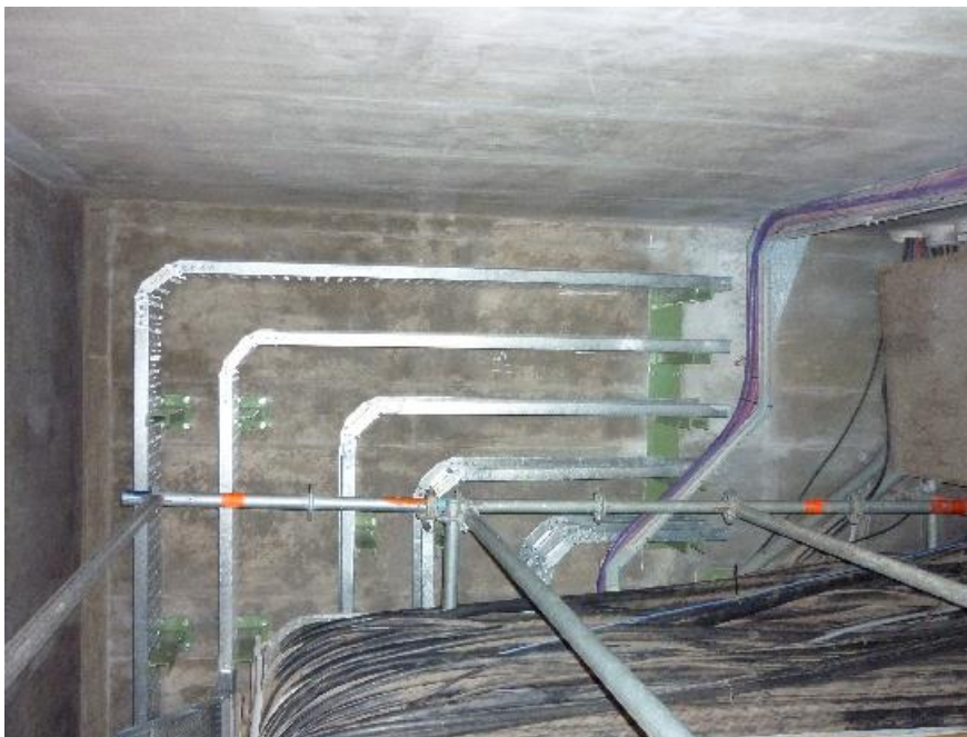
Foto 16. Cámara eléctrica considerada como espacio confinado.
