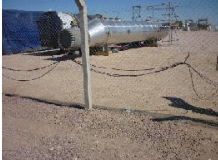
Foto 7. Conductores eléctricos colgados con ganchos aislantes
