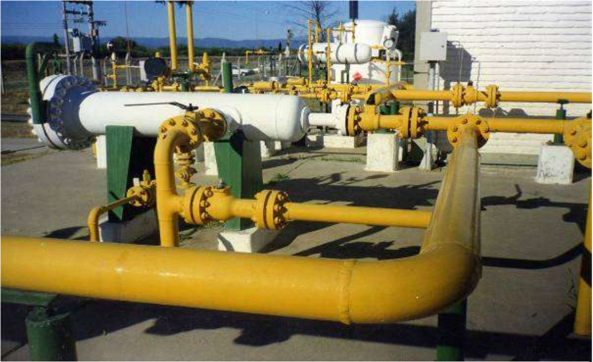
Estación reguladora de Gas
