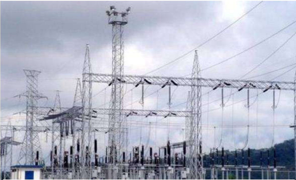
Estación transformadora de Electricidad. FIG. 11.6
