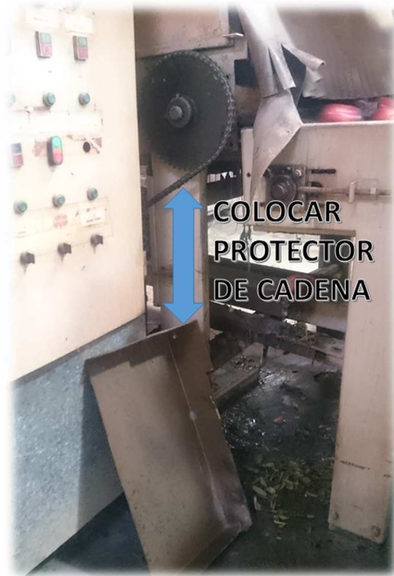
Imagen 35 – Túnel de secado
