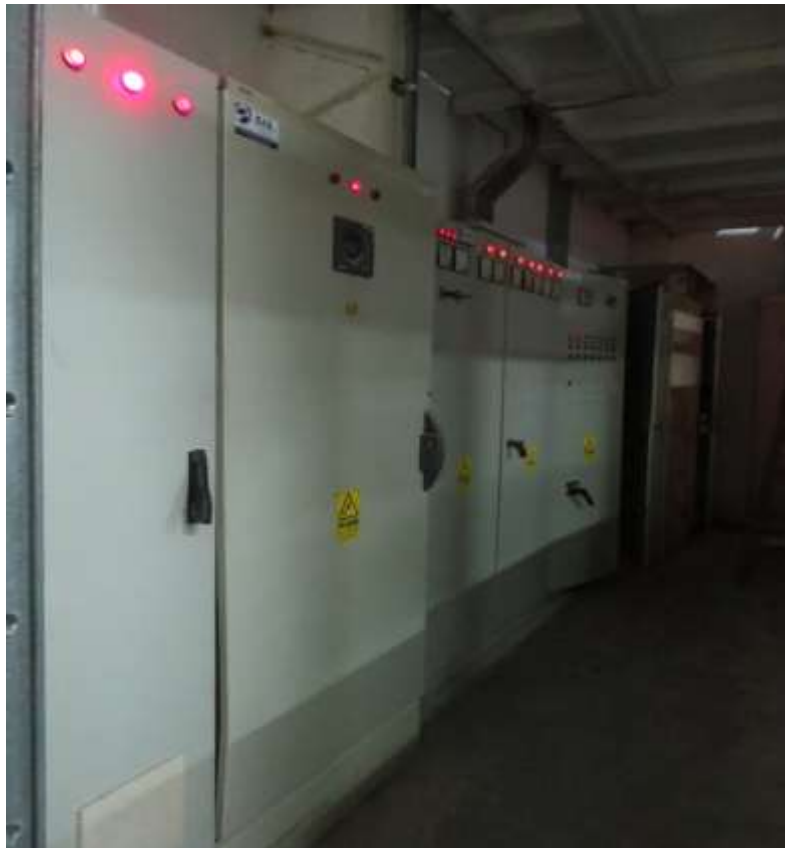
Imagen 2.13 Tableros eléctricos y de PLC
