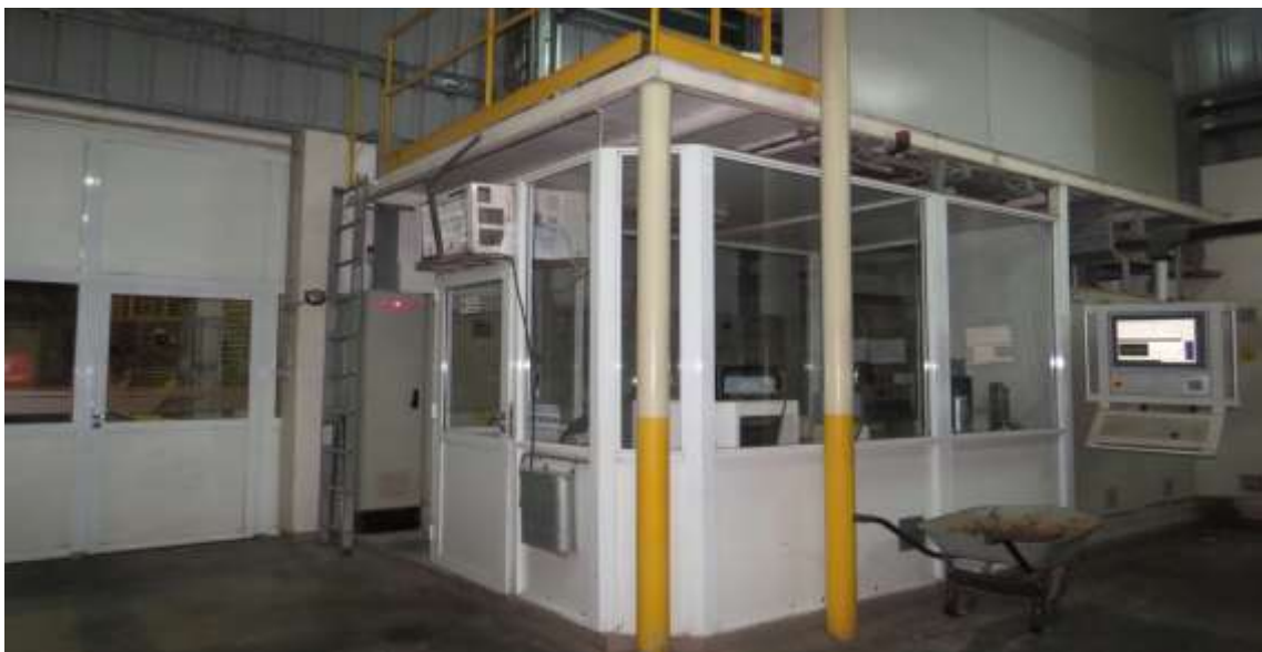
Imagen 2.12 Centro de control de mando de extrusores
