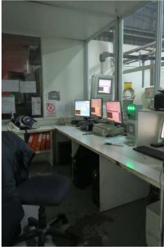
Imagen 2.14 Interior de cabina de control de mando
