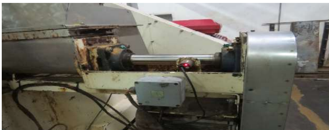
Imagen 2.18 Riesgo de atrapamiento
