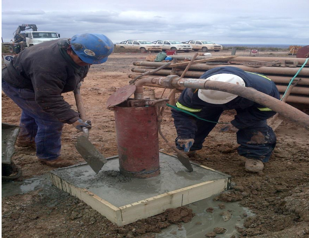
Figura: finalización de pozo con capuchón a tapa con candado y dado de cemento
