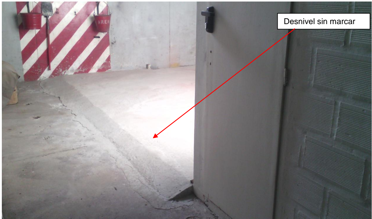
Figura 2.7: Zona de tránsito con desnivel
