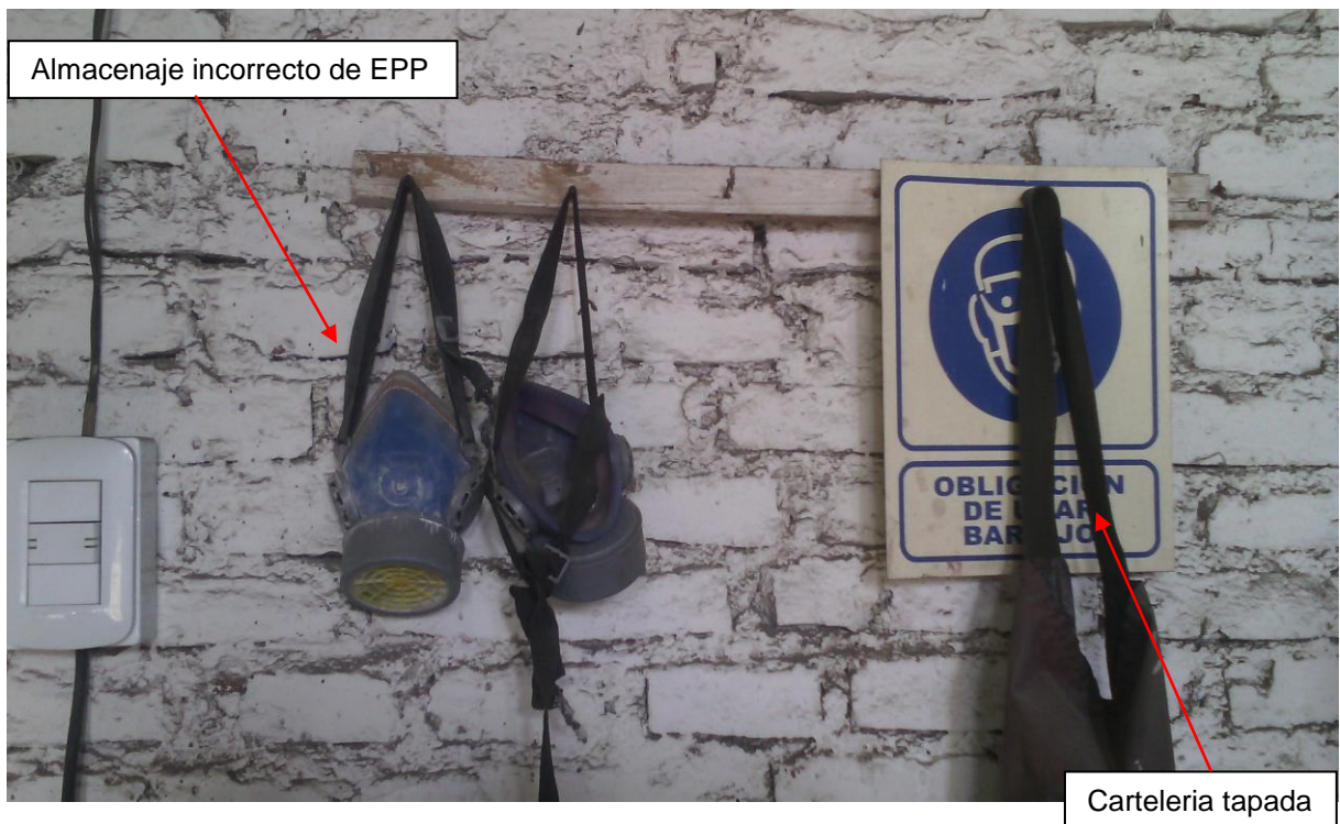
Figura 2.9: Almacenamiento incorrecto de EPP
