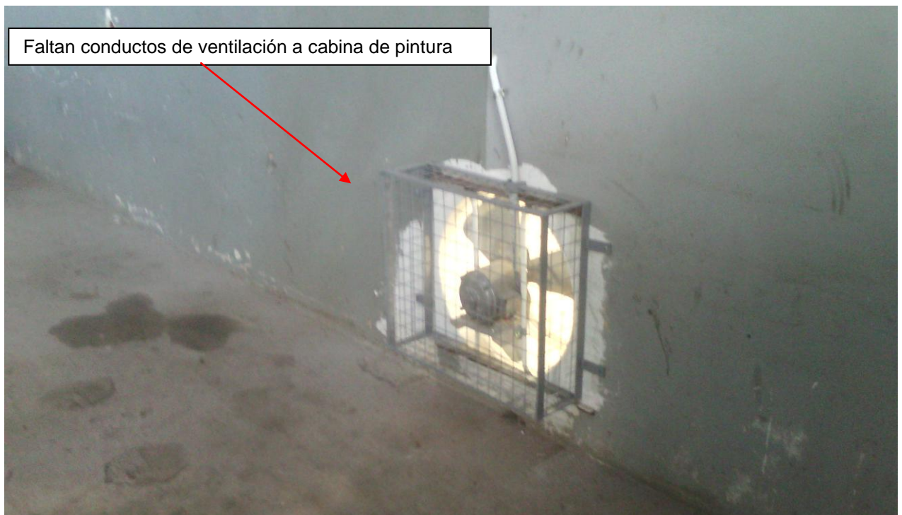
Figura 2.5: Extractor de cabina de pintura sin conductos
