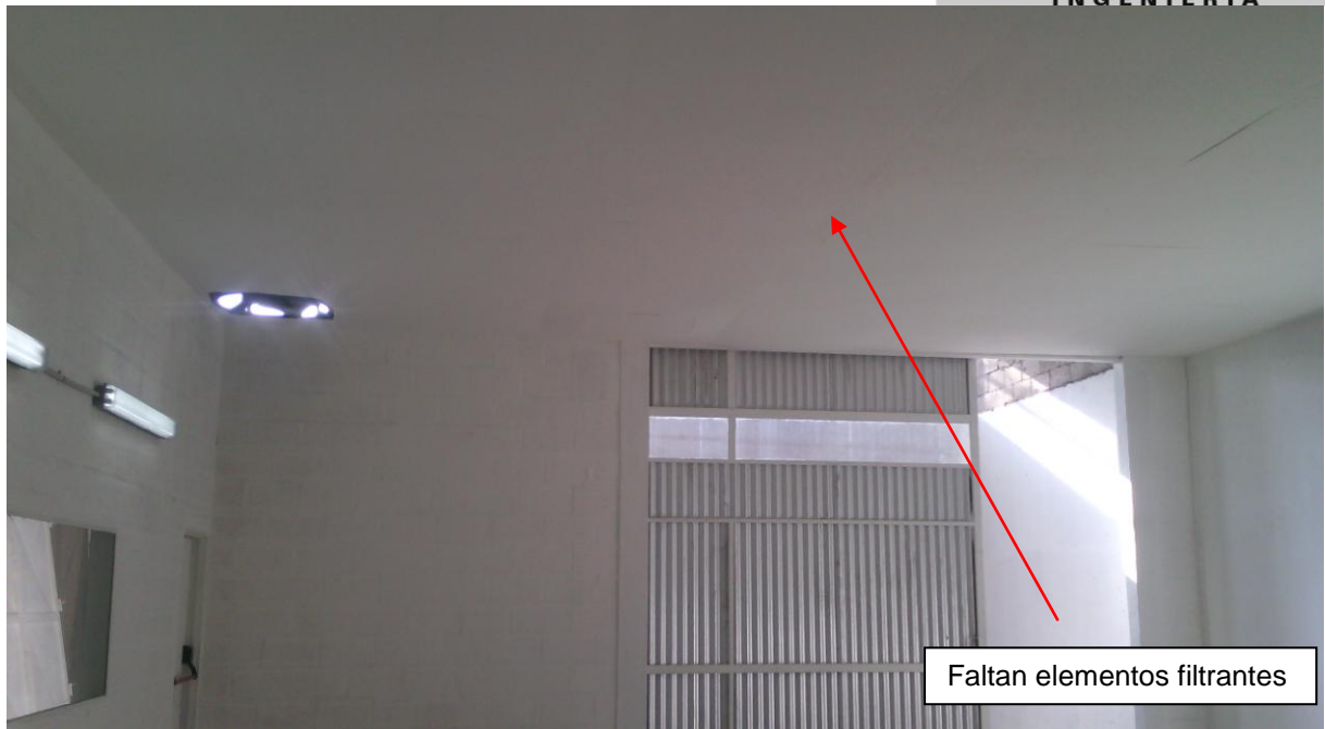
Figura 2.6: Techo de cabina de pintura sin elementos filtrantes
