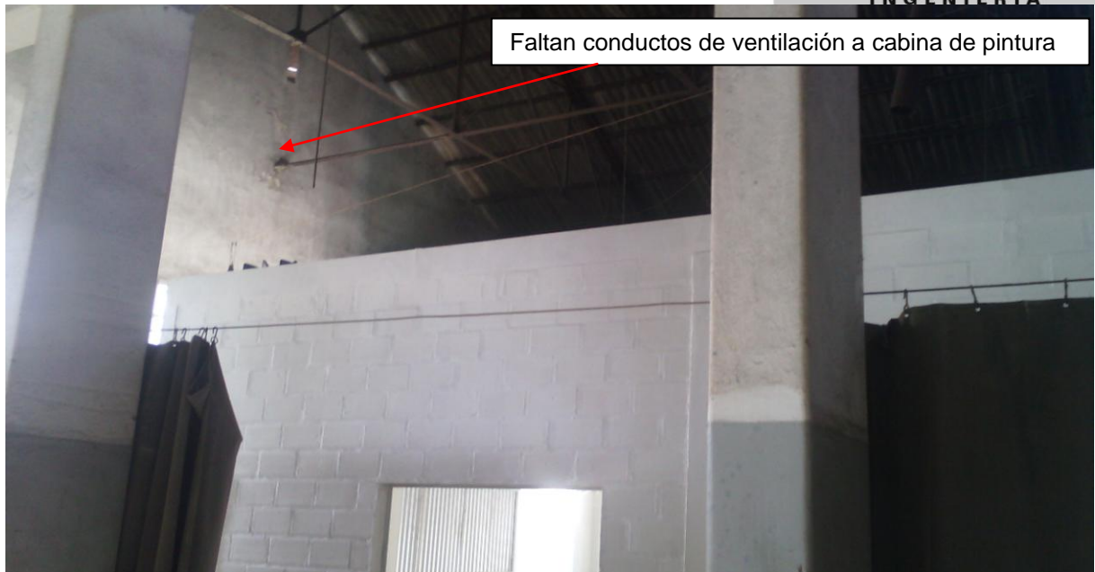
Figura 2.4: Parte superior de cabina de pintura sin conductos
