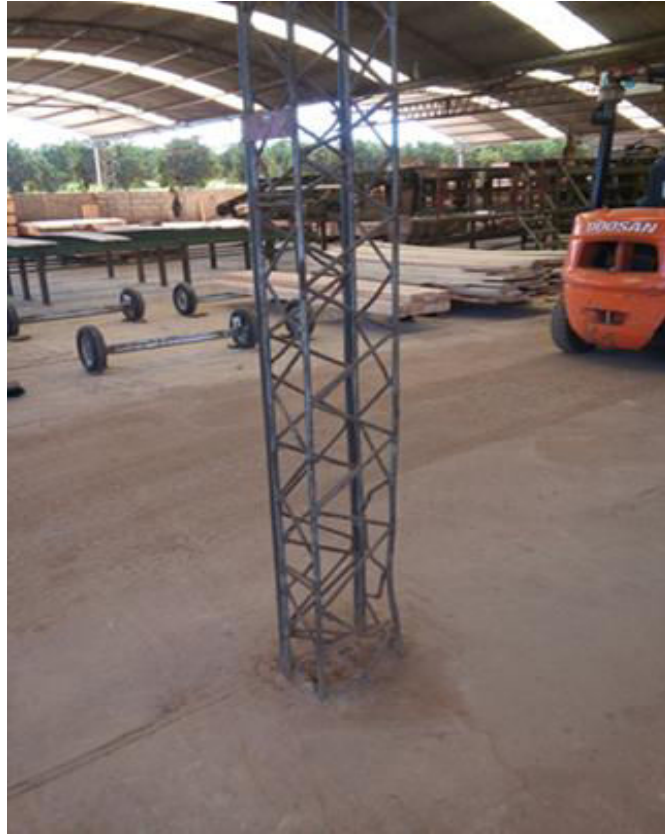
Figura 2.26 ilustración columna sin hormigón.
