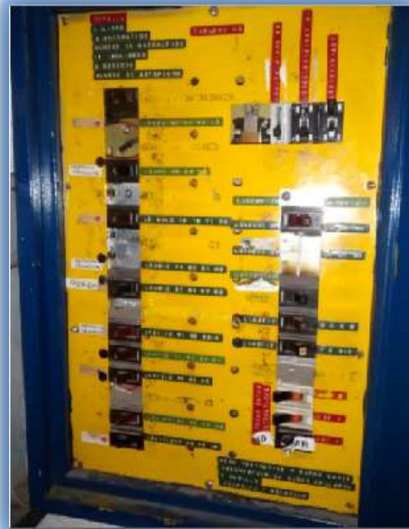
Foto 1 - Tablero eléctrico principal
