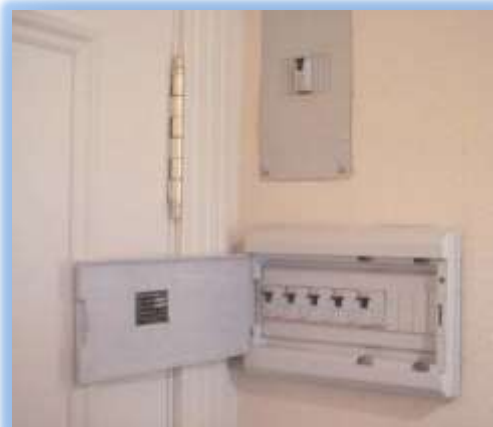
Foto 2- Tablero eléctrico secundario (oficina de personal)
