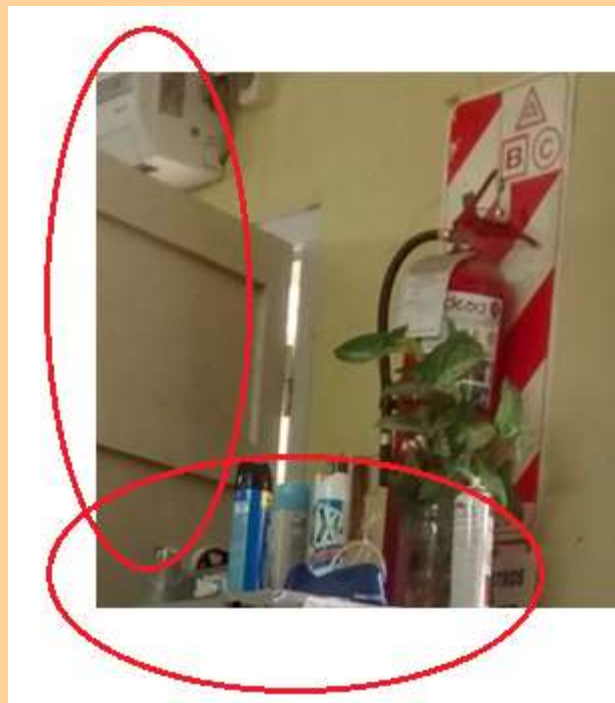
Fig. 6 – Riesgo de incendio
