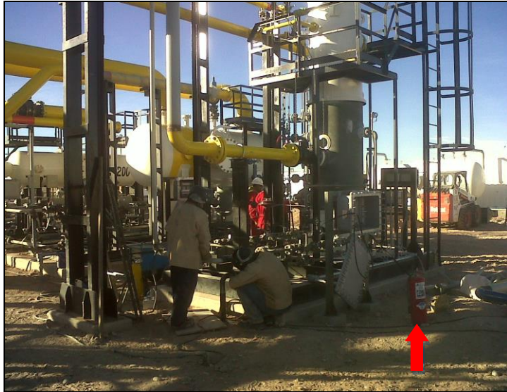
Extintor de polvo químico tipo ABC de 10 kg en frente de trabajo de corte, amolado y soldadura.
