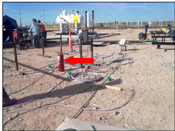
Extintor de HCFC 123 tipo ABC de 5 kg en tableros eléctricos primarios y extintor de polvo químico seco tipo ABC de 10 kg en tableros secundarios.
