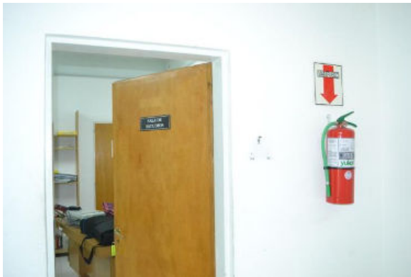
El único extintor colgado con su respectiva chapa baliza y con fecha apta para su uso, ubicado en pasillo de acceso a la Sala de Estudio.
