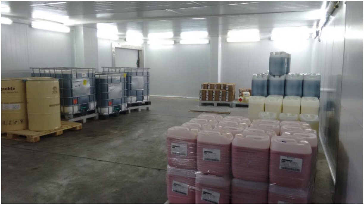
Fig. N° 25 – Cámara de frío.
