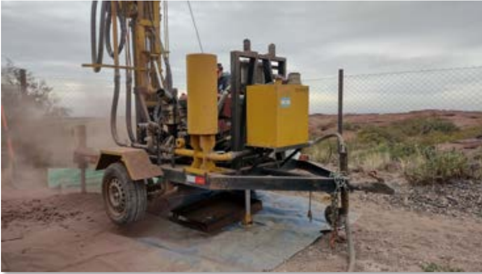
Lonas y bandeja de contención frente algún posible derrame
