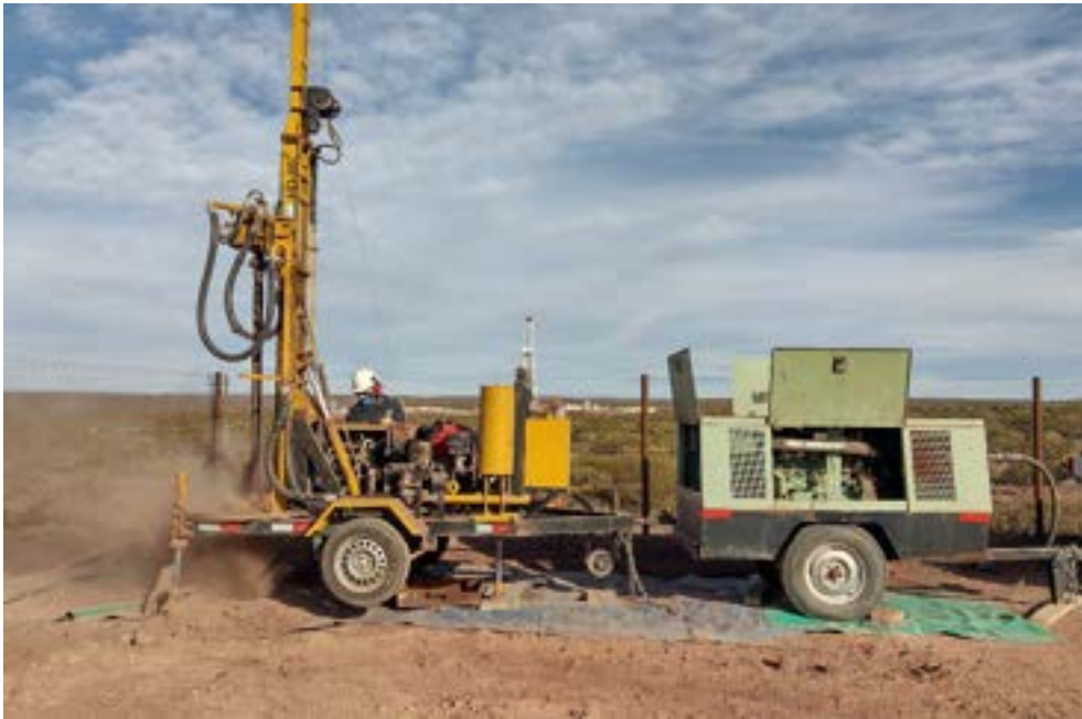
Ubicación de equipos – De izquierda a derecha – Equipo de perforación - Compresor de aire
