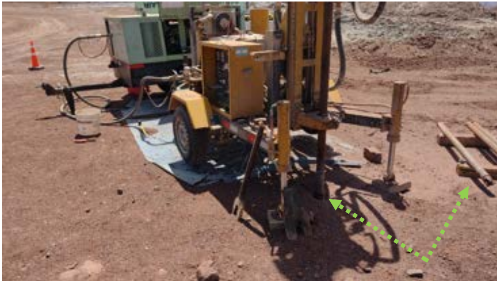
Se observa en verde la ruta que sigue el operario
