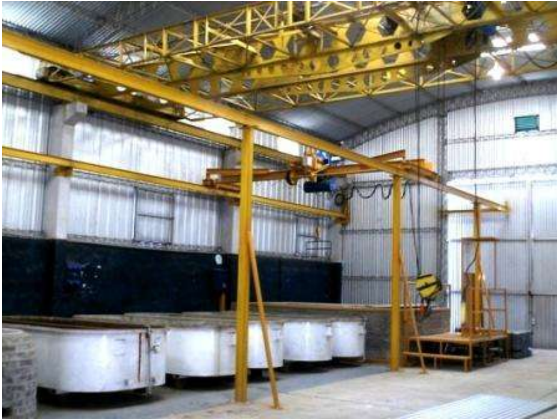
Figura 8 – Puentes grúas utilizados para el proceso de galvanizado.
