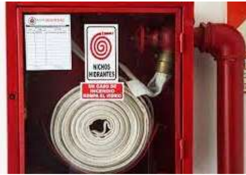
Estación fija de lucha contra el fuego – Nicho hidrante
