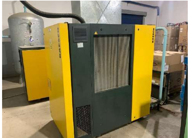
Imagen N °2 – Compresor Kaeser
