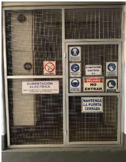
Imagen N °1 - Subestación
