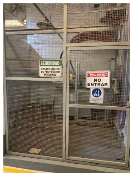
Imagen N °4 - Subestación
