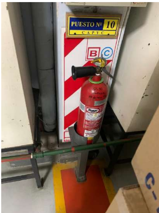
Imagen N °3 – Extintores
