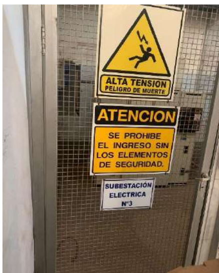
Imagen N °3 - Subestación
