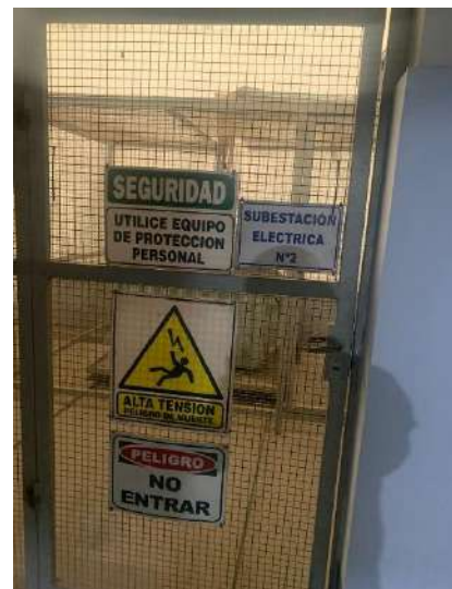
Imagen N °2 - Subestación
