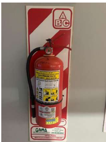
Imagen N °3 – Extintor polvo químico
