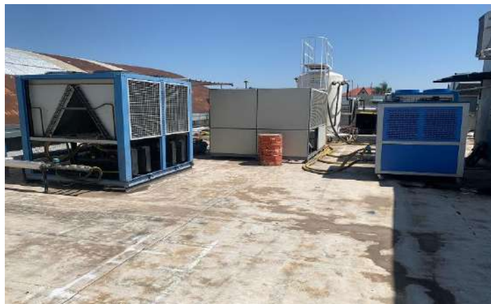
Imagen N °1 – Equipos de fríos
