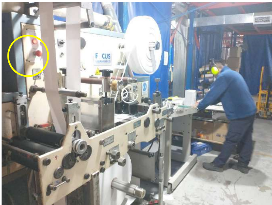
Pulsador de emergencia
