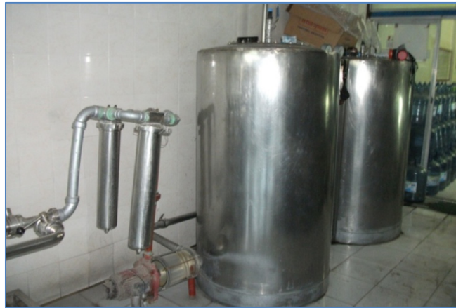
Figura N° 11. Tanques con lecho de grava y arena
