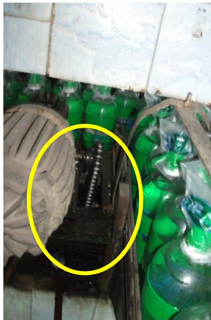
Figura N° 30 – Piñón y engranaje sin protección
