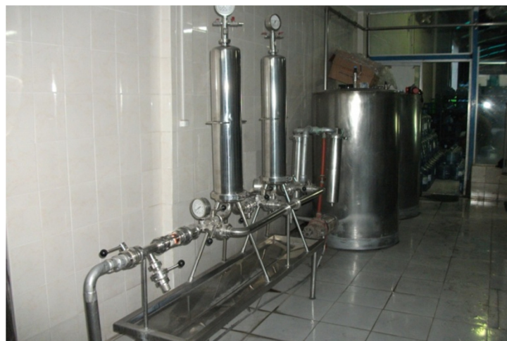
Figura N° 12. Filtros con carbón activado
