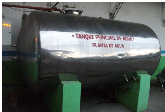
Figura N° 6. Tanque de agua principal
