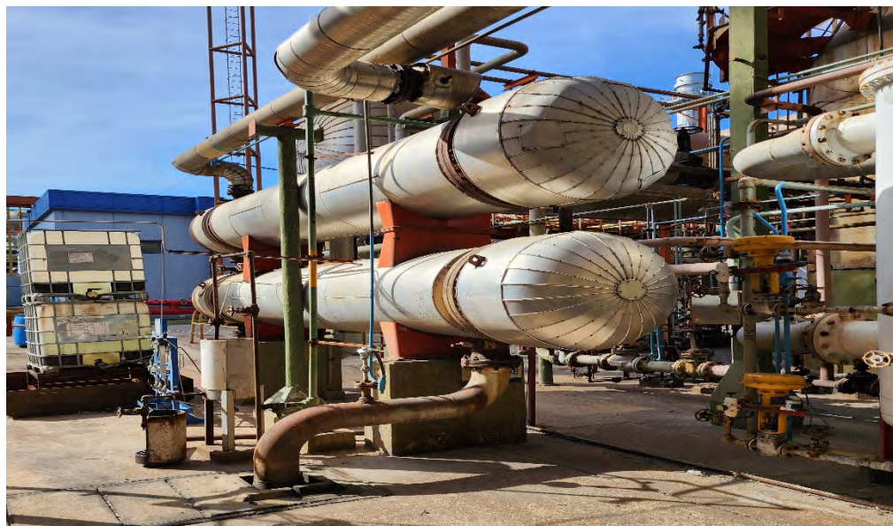
Figura 1.7. Intercambiadores (Fuente: Elaboración propia)
