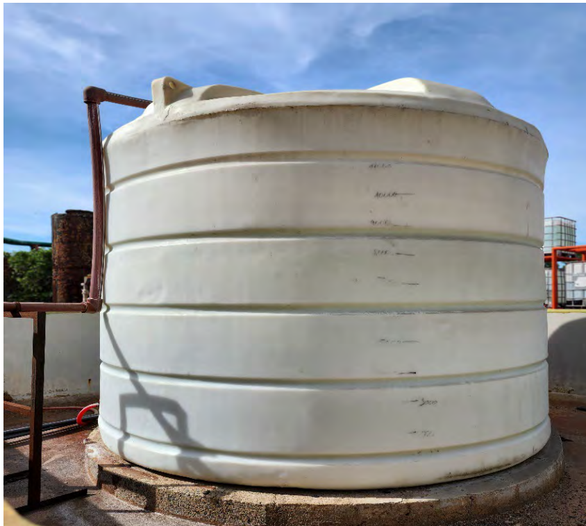
Figura 1.7. Tanque de almacenamiento de producto final. (Fuente elaboración propia)
