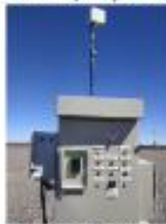
Contactor con pump-off
