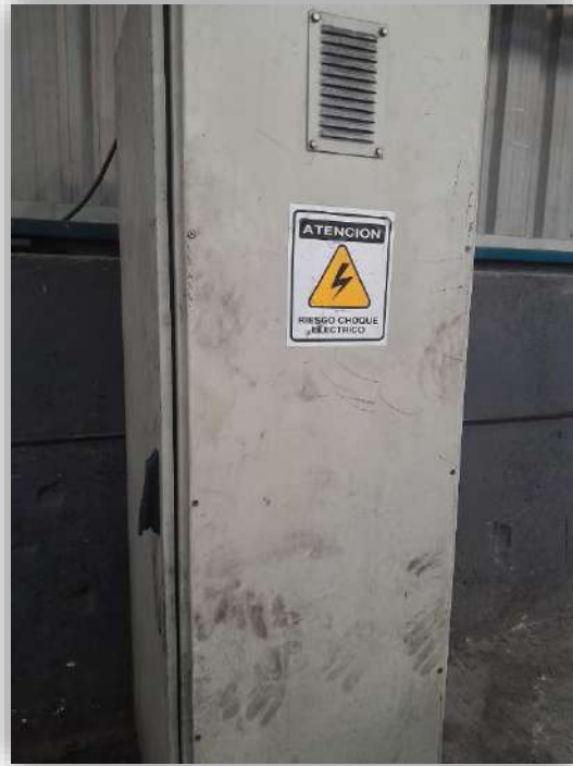
39 Advertencia de choque eléctrico
