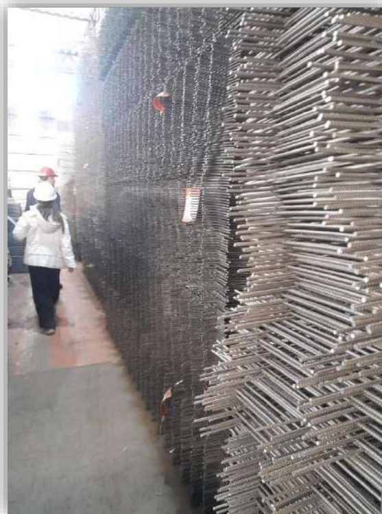
17 Zona de circulación obstruida
