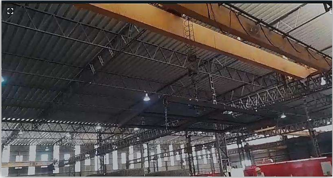
41 Puente grúa de Donadio en funcionamiento
