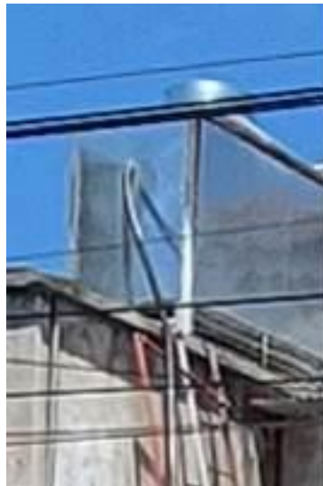
Foto 7 Torre de refrigeración
