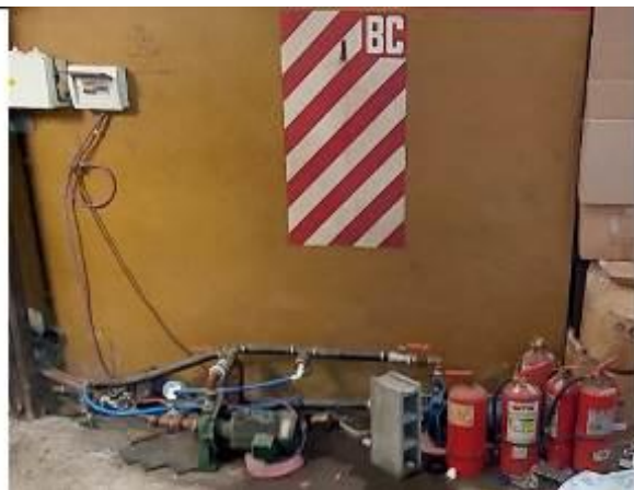
Foto 25 Bombas de agua y extintores.
