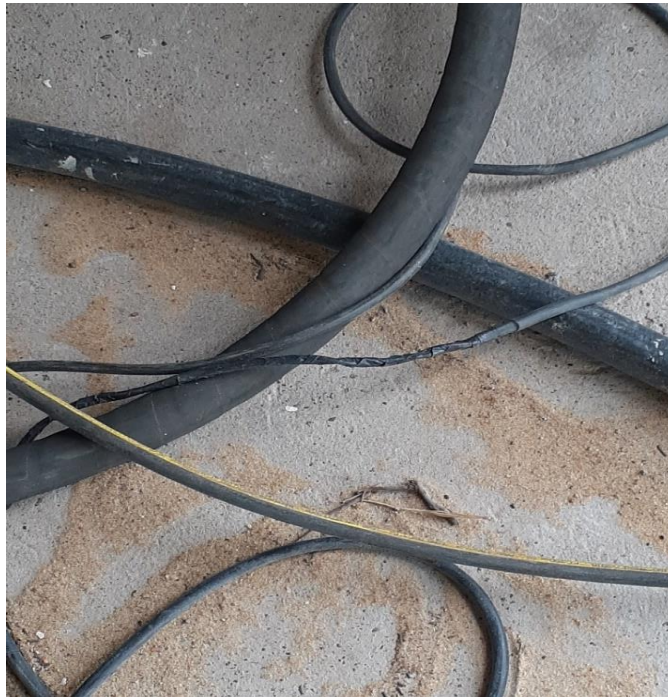
IMAGEN 30: CABLES REPARADOS CON CINTA
