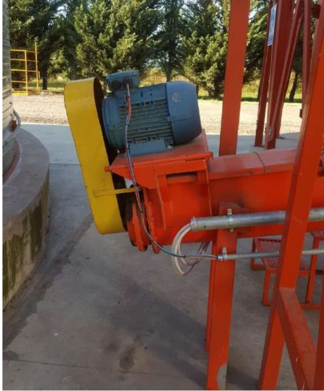
Imagen: Cableado sin canalización
