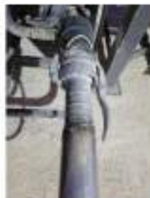
Conexión de manguera de descarga de cal.
