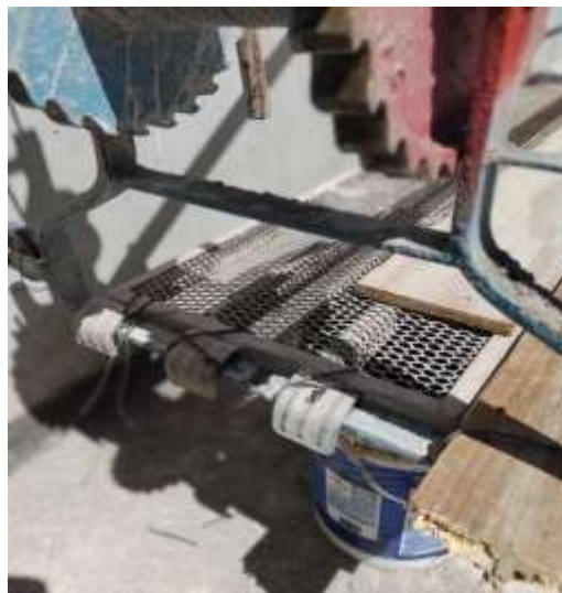
Plataforma de trabajo metálica
