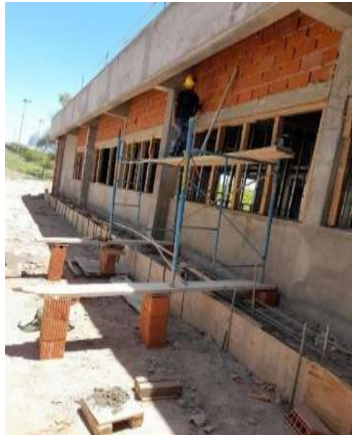
Deficiencia: nivelación de andamio
