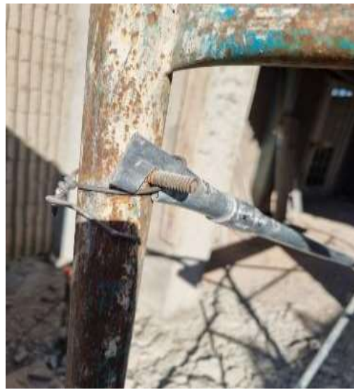
Piezas de unión inadecuadas
