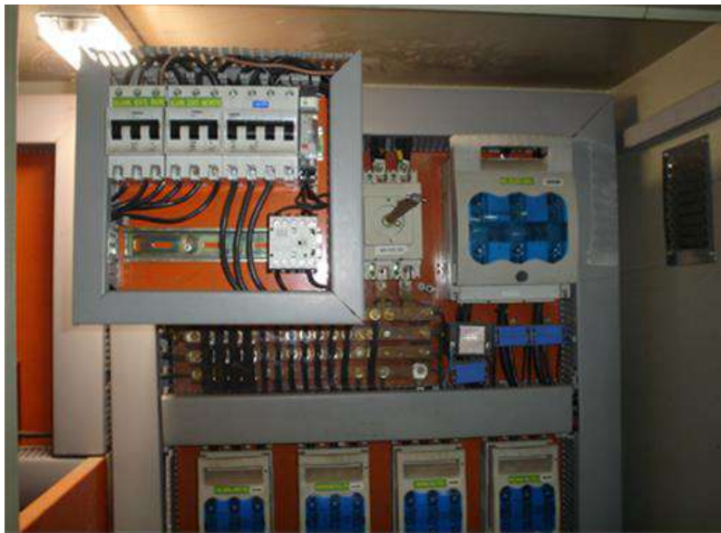
Figura 3.3 Tablero general de corte de energía eléctrica.
