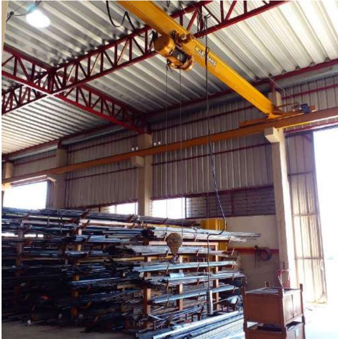
Figura 2.3.5 Puente de Grúa 1.
