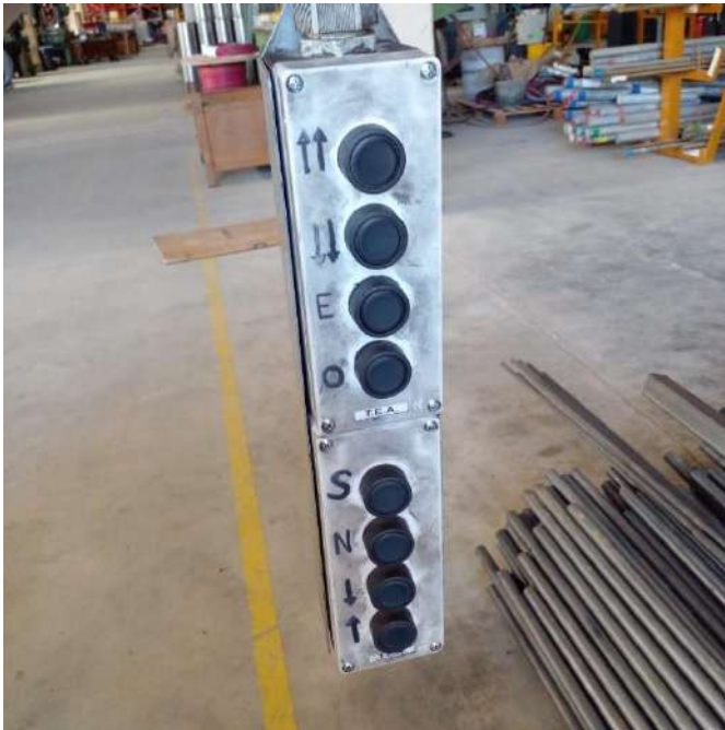
Figura 2.3.7 Control del puente de grúa 1.
