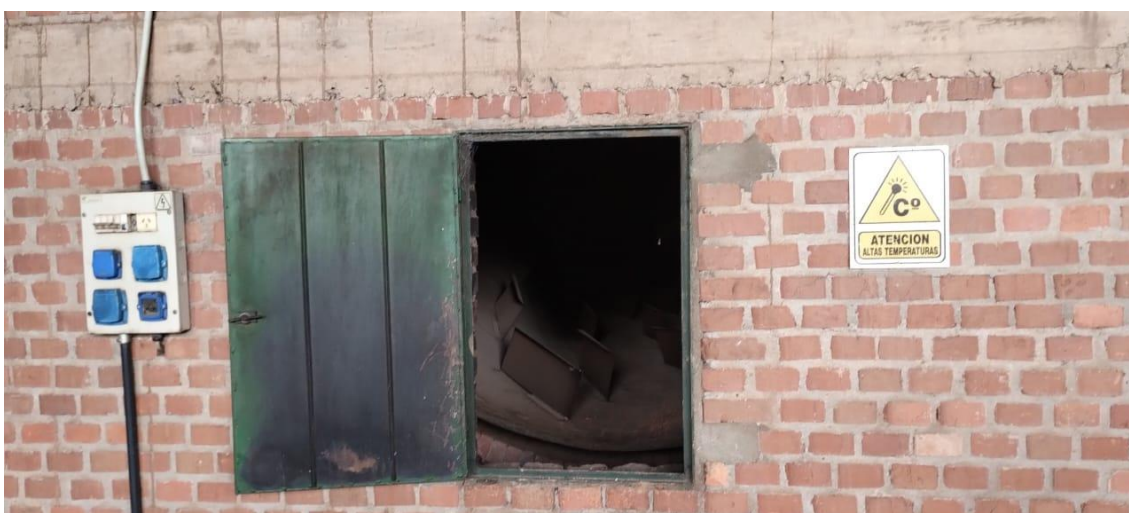
Imagen Toma corriente Sector sapecado se encuentra en condiciones normales cumpliendo con la seguridad. Por otro lado, el cableado que distribuye la energía eléctrica en la planta se encuentra en los sectores
