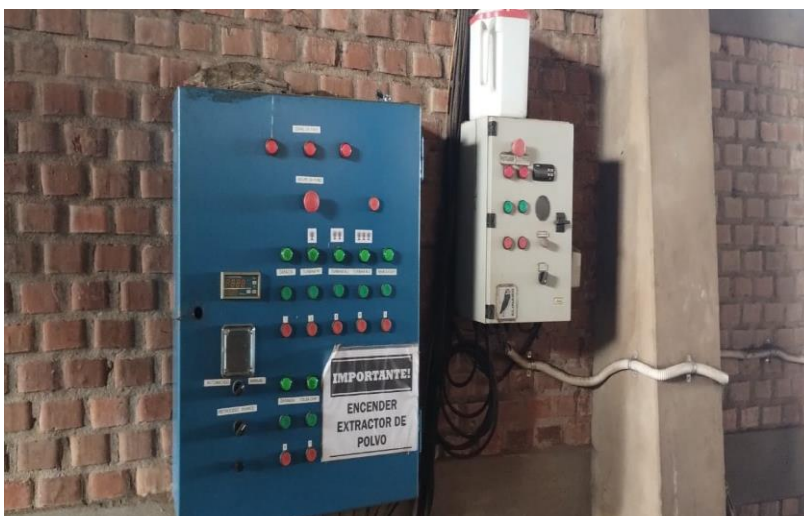
Imagen exterior de tablero eléctrico del Sector sapecado materia prima.
