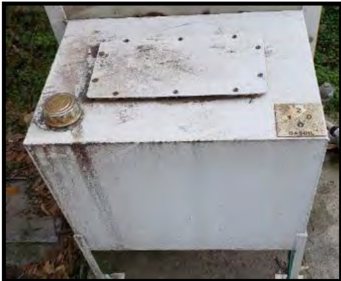
Tanque externo de Gasoil
