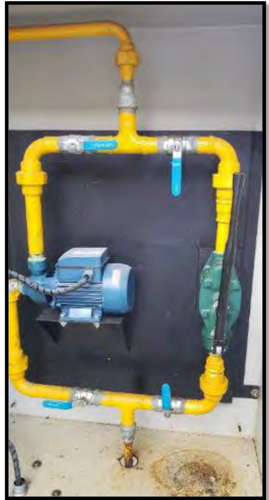
Cuerpo de bombas de combustible
