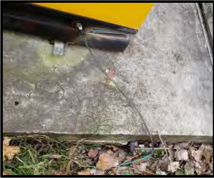
Pletina y Puesta a tierra de grupo electrógeno
