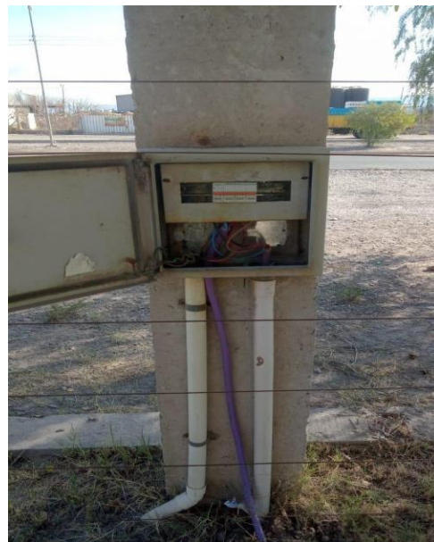
1. Tablero general ingreso planta
