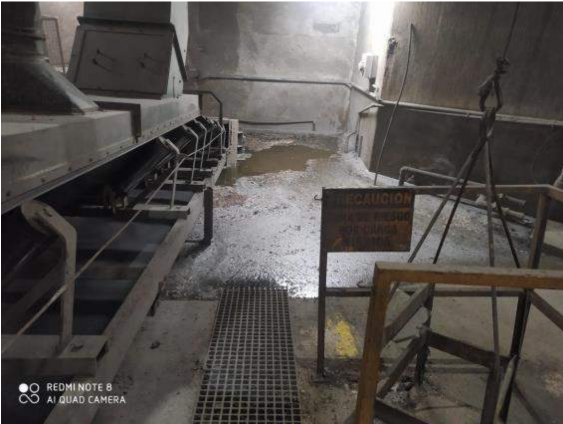
Túnel cinta transportadora
