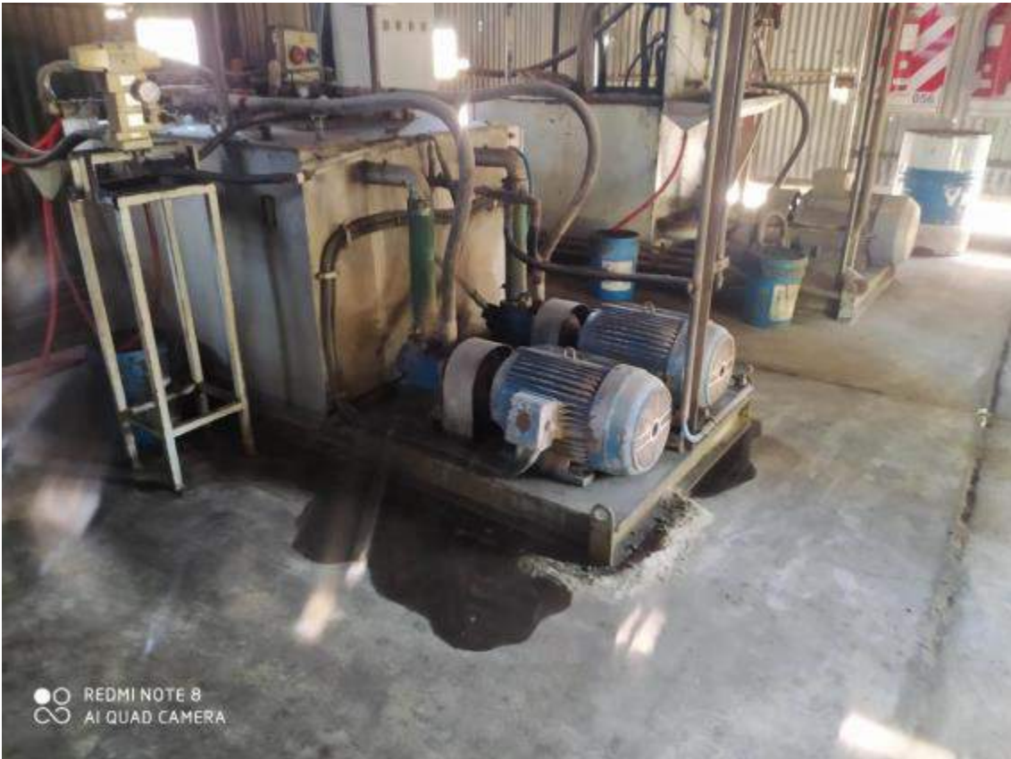
Sala de bombas hidráulicas de plataformas volcadoras
