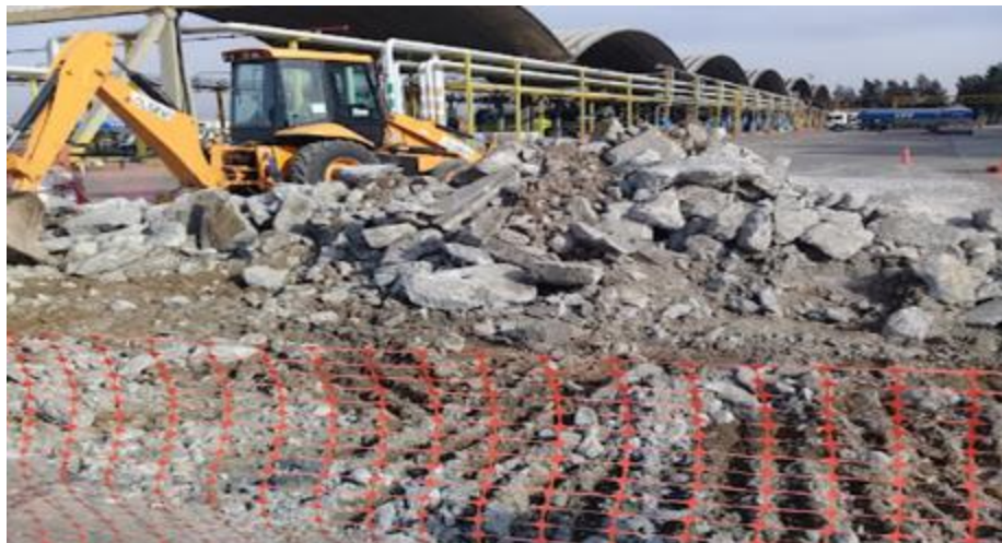
Figura 2.1 rotura de hormigón
