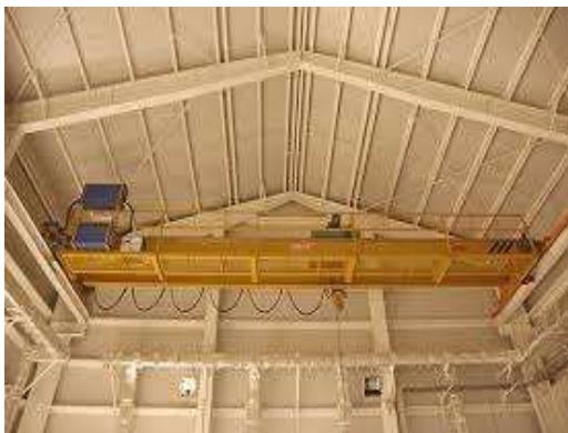
ILUSTRACIÓN 7 PUENTE GRÚA DE 7 TONELADAS
